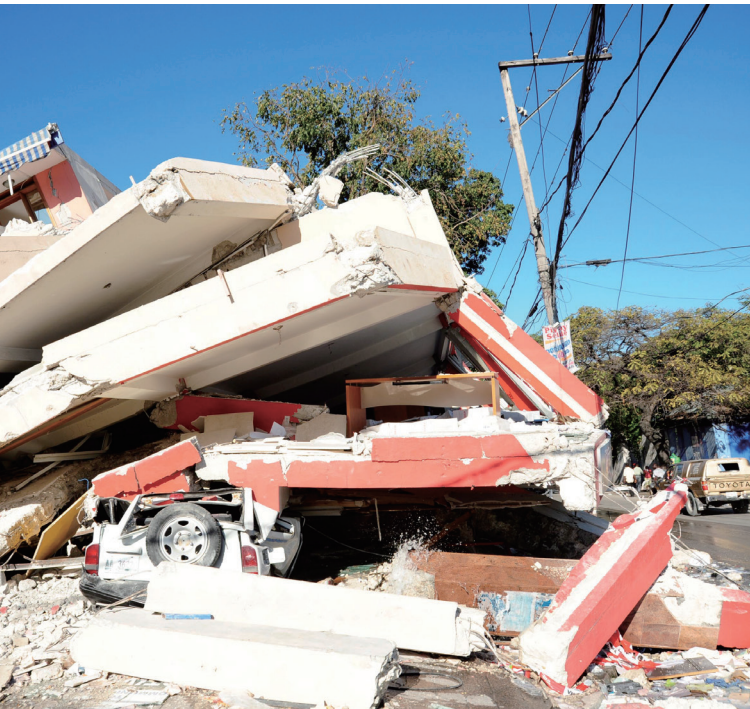
倒壊した建物
