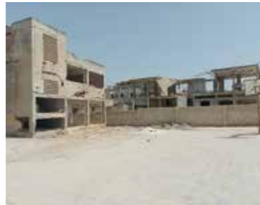
空爆によって破壊された校舎
