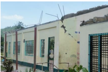
台風により屋根が破損した小学校の校舎
